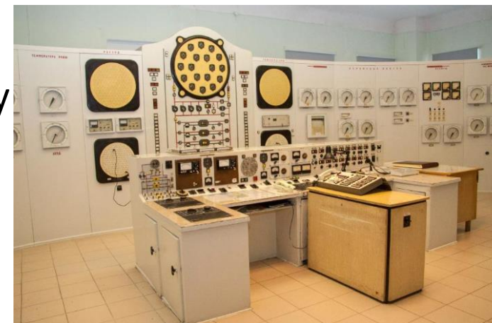
Riadiaca miestnosť jadrovej elektrárne APS-1.
